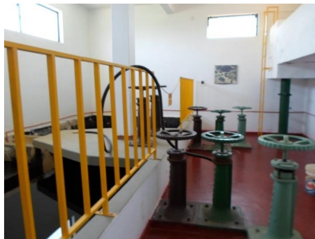
Figura 18: Elevatória de água tratada (ETA 2) Fonte: Conen
