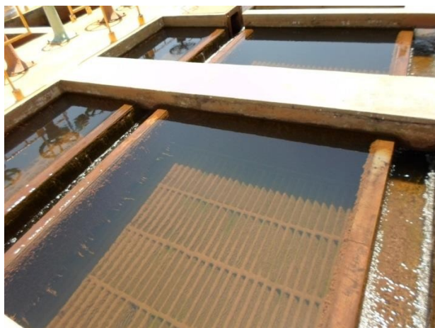
Figura 17: Decantadores Fonte: Conen
