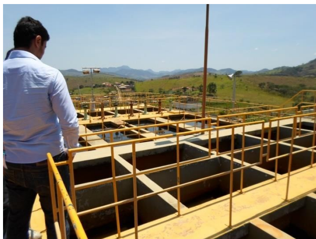
Figura 15: Instalações de tratamento (ETA 1) Fonte: Conen
